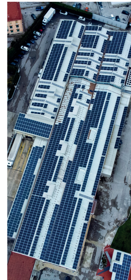
Impianto Fotovoltaico - SO.F.A. Srl Arzano (NA) Potenza 490 kw
