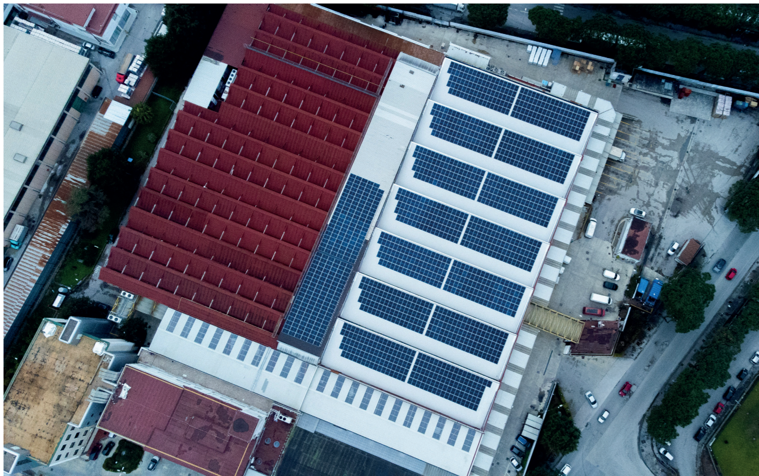
Impianto Fotovoltaico - Immenso Cash Gruppo Colonial Sud SPA Arzano (NA) - Potenza 600kwp
