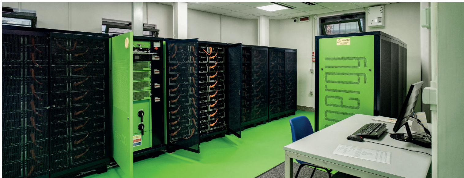
Sistema di Accumulo di Energia Industriale - SO.F.A. Srl Arzano (NA) - Capacità di Stoccaggio Energia 500 kWh
